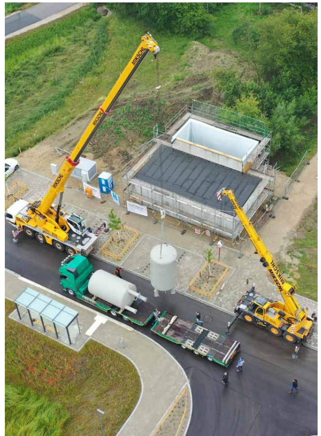
Citrin Solar installiert immer wieder Sonderspeicher.
