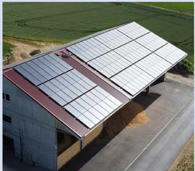
Prozesswärmeanlage zur Nutzung einer thermischen Solaranlage von CitrinSolar im Bereich der Landwirtschaft.
