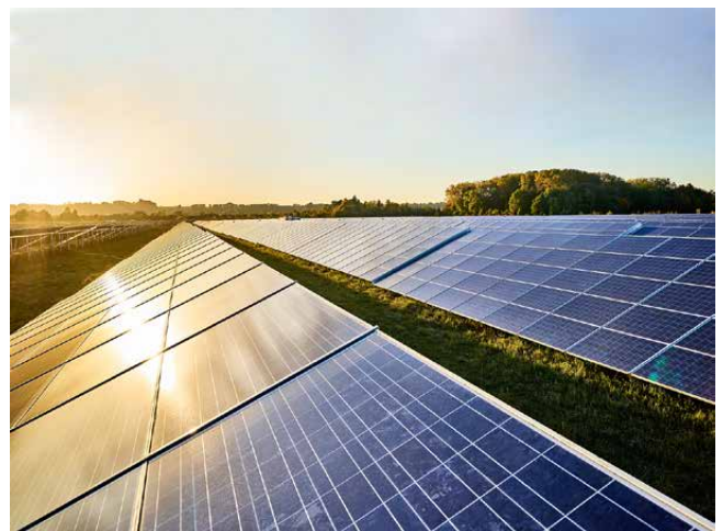
Solarpark von hep in Nordendorf. / Foto: hep
