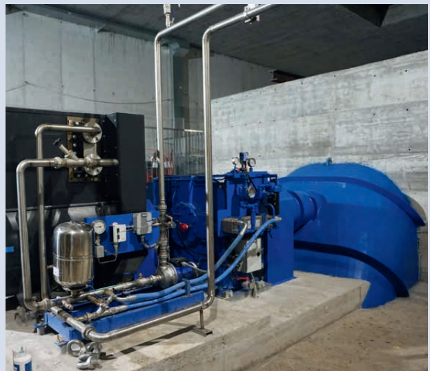
Blick in das Kraftwerkshaus der im April 2015 in Betrieb genommenen Wasserkraftanlage Pellerina in der Turiner Innenstadt.
