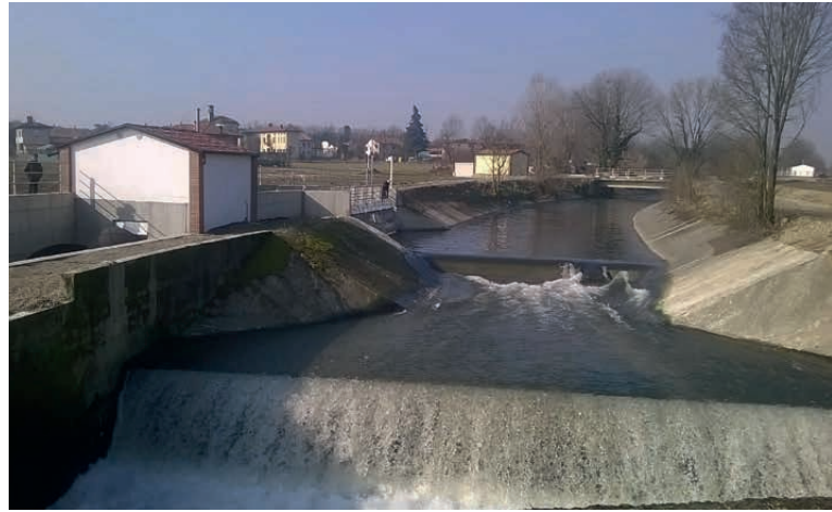
Links im Bild das Kraftwerkshaus einer der beiden Wasserschnecken die an einem Abwasserkanal südöstlich von Mailand in der Lombardei errichtet wurden.
