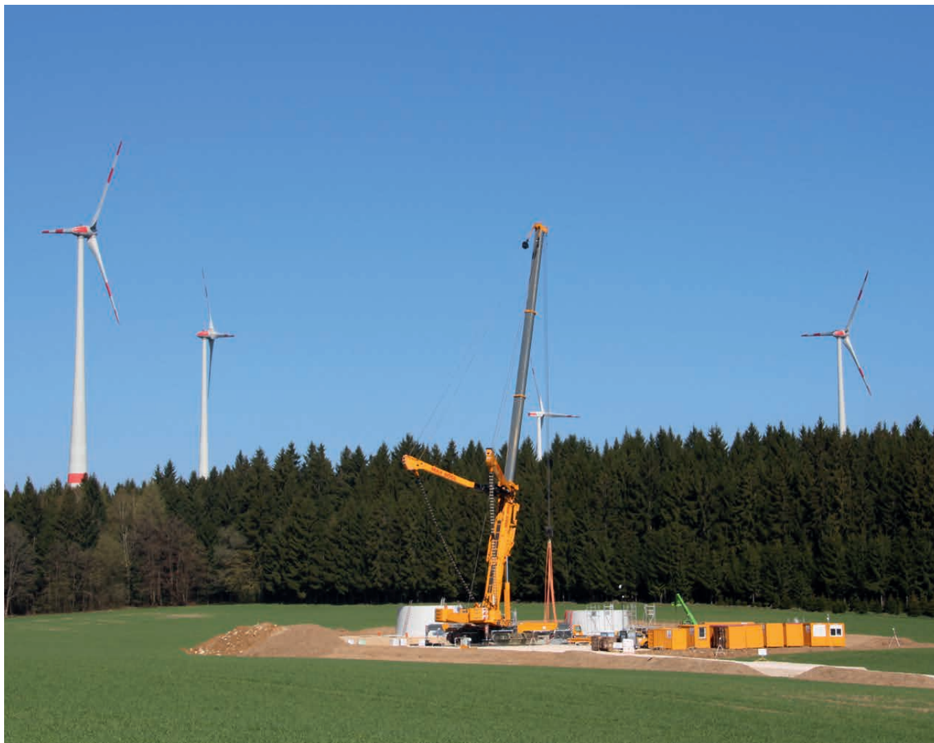
Die Errichtung von fünf Windenergieanlagen im bayerischen Velburg schreitet planmäßig voran, die Inbetriebnahme ist im Sommer 2015 geplant.
