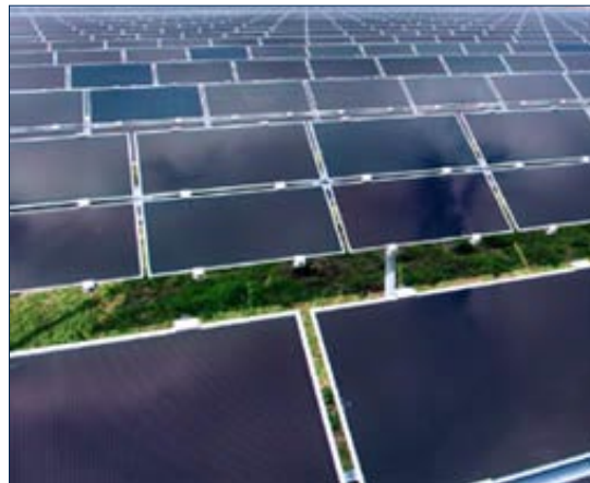
Module des Solarprojekts
