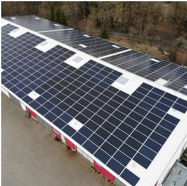
Eine weitere Solaranlage von Ranft Invest in Clausthal.
