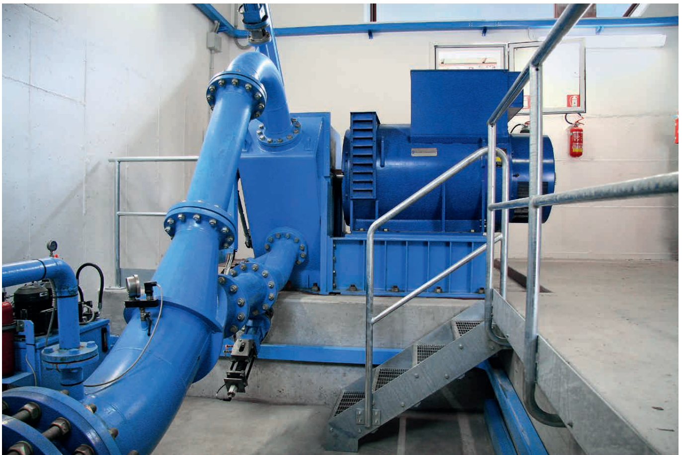
Turbine des Wasserkraftwerks Vallesina (Teil des Kraftwerkspark II). Eine vergleichbare Turbine wird im Wasserkraftwerk Venetien (geplante Investition der Emittentin) zum Einsatz kommen.
