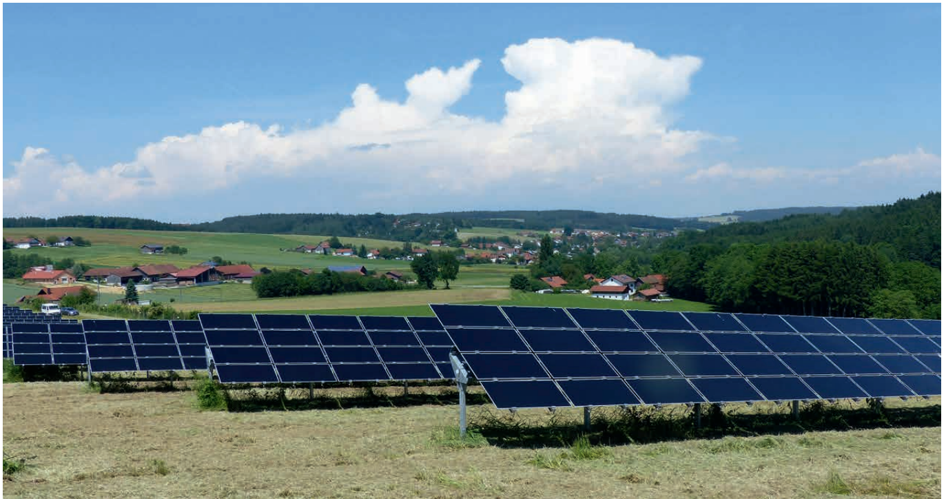
Seit Jahren können Anleger bei UDI in Erneuerbare Energie investieren. Im Bild der UDI-Solarpark Grafenau.
